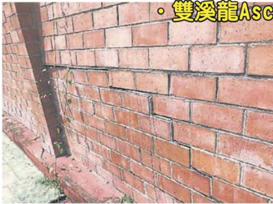
■ 围墙开始龟裂。
